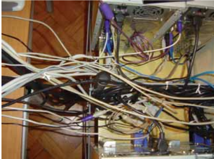
Fig. 33 – A proliferação de fios provoca um efeito visual desagradável e favorece a muitos problemas de conexão, mau contato, perda de sinal e desperdício de energia dissipada.
