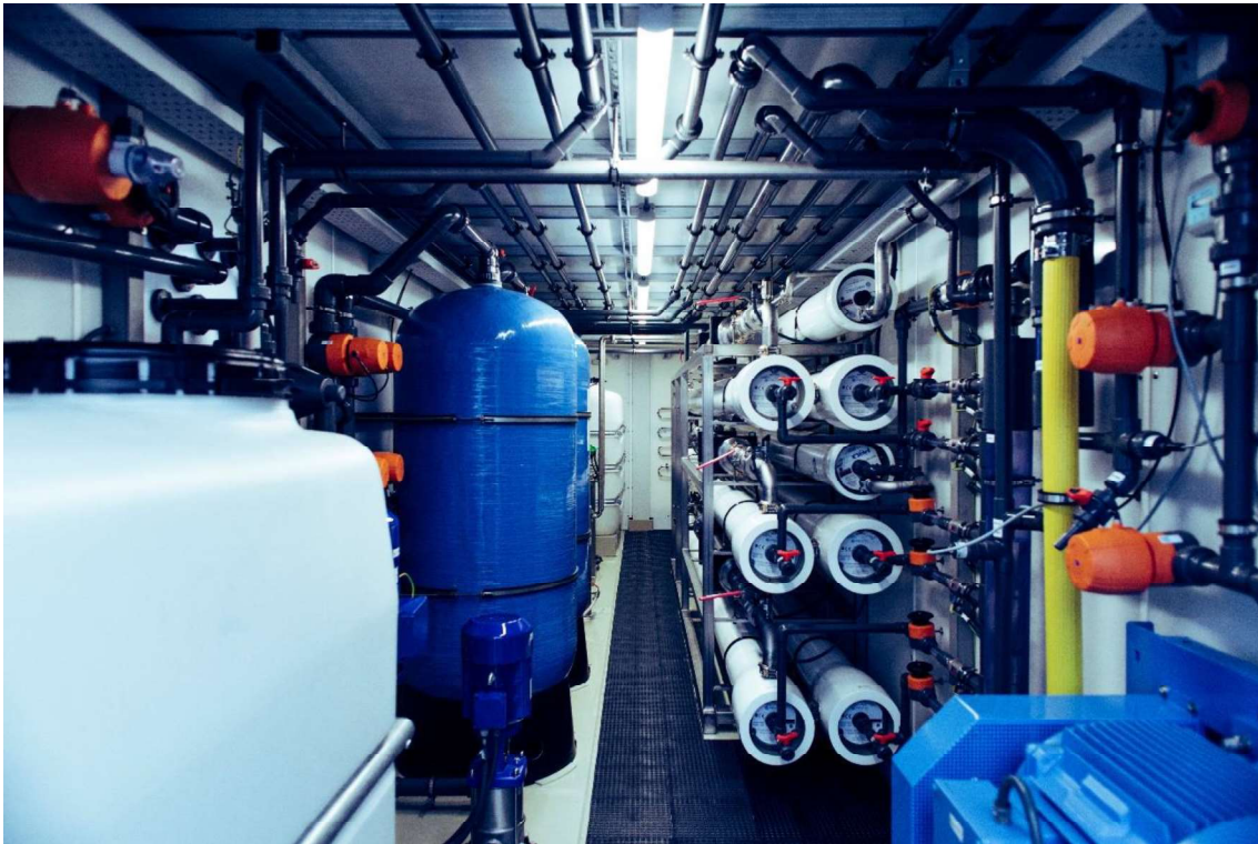
Figura 2: Interior de uma máquina de tratamento de osmose reversa.
