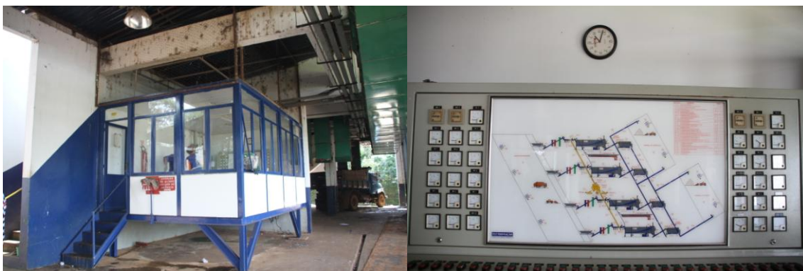
Figura 6.16 – Central de controle e comando e foto do painel da IRR Asa Sul – Tecnologia Dano Fotos: Kátia Campos Brasília – 2012
