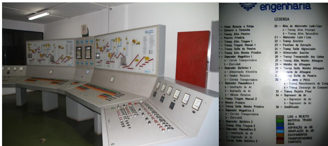
Figura 6.19 - Painel de controle e comando com detalhe da legenda dos equipamentos da IRR Ceilândia. Fotos: Kátia Campos Brasília – 2012
